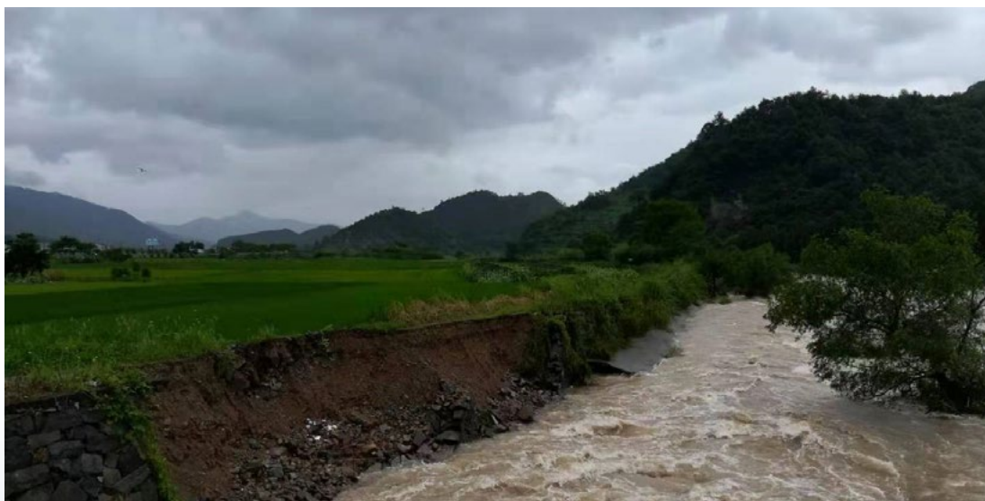
堰坝下游挡墙被冲毁
