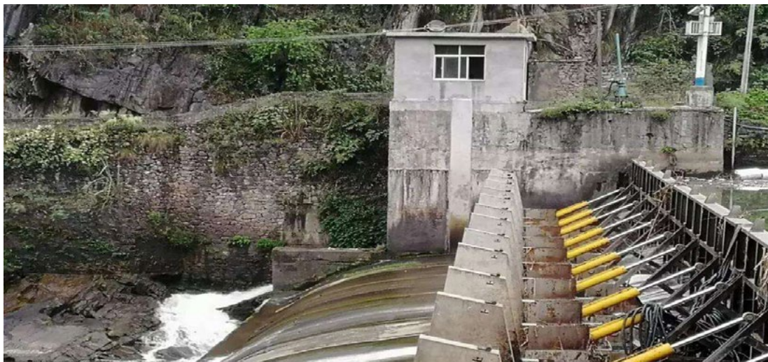
电站引水堰坝 设置生态放水孔
