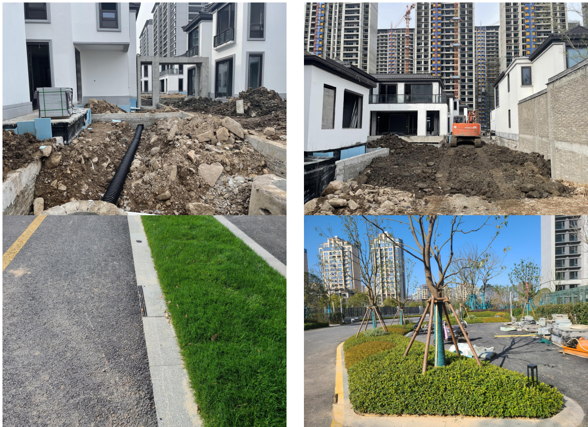
雨水管线及雨水井设施
