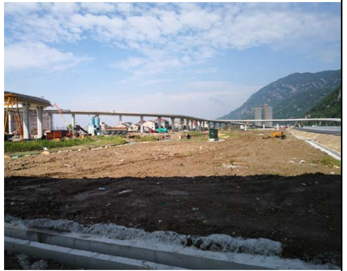
部分护岸后侧土方裸露
